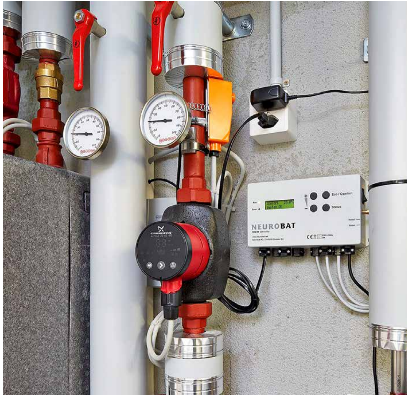
Ausgestattet mit einer Fülle an Informationen, können smarte Heizungssteuerungen wie das Neurobat NiQ die Heizkurve anpassen und Energie sparen. BILD ZVG
